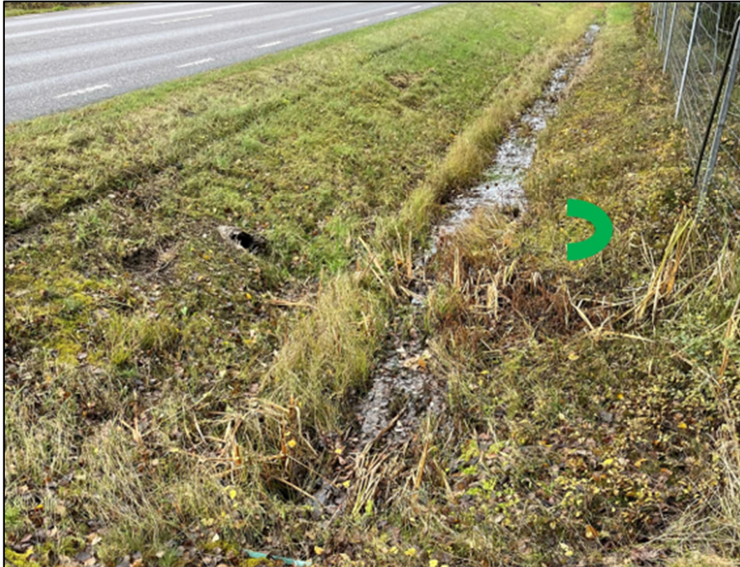
Figur 31. Visar illustrativt var trumma på andra sidan diket anläggs för att leda vidare överskottsvatten.
